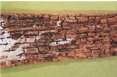
Porenschwamm in Holzbalken
