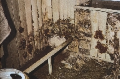
Echter Hausschwamm in Mauerwerk
